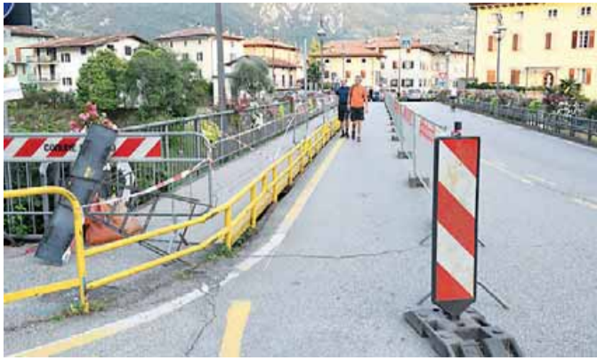
Il ponte di Arco e la passerella pedonale danneggiata
